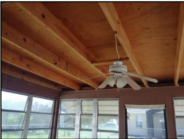
Rear enclosure fan
