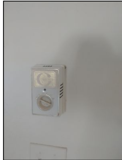
Control for patio fan in DR
