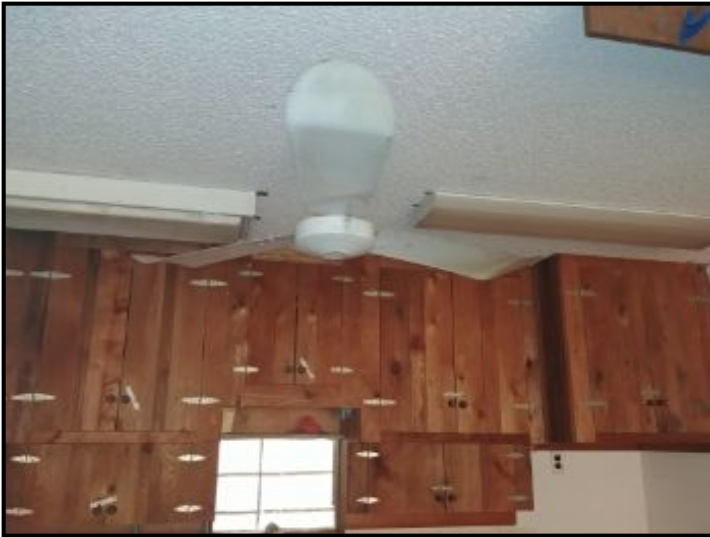
Wood cabinets and fan
