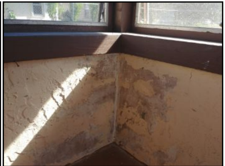
Loose/peeling paint- patio wall
